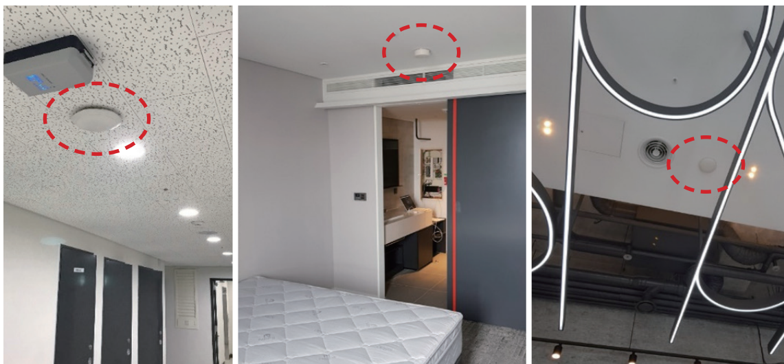
▲ 호텔에 실제 설치된 WAC6103D-1와 NWA5123-AC
