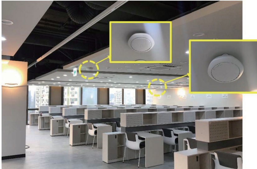
▲ 스마트 학원/독서실 'WAC6502D-S' 설치 전경
